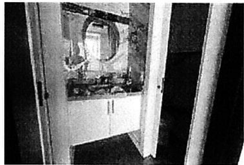
Lavabo baños centrales
