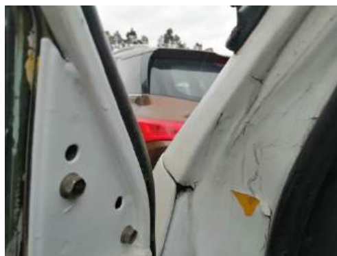
Foto 20 PARTE BAJA DE PARANTE CON FISURA
