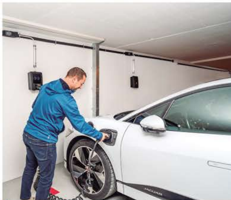
■ O condomínio não deve permitir instalações improvisadas
