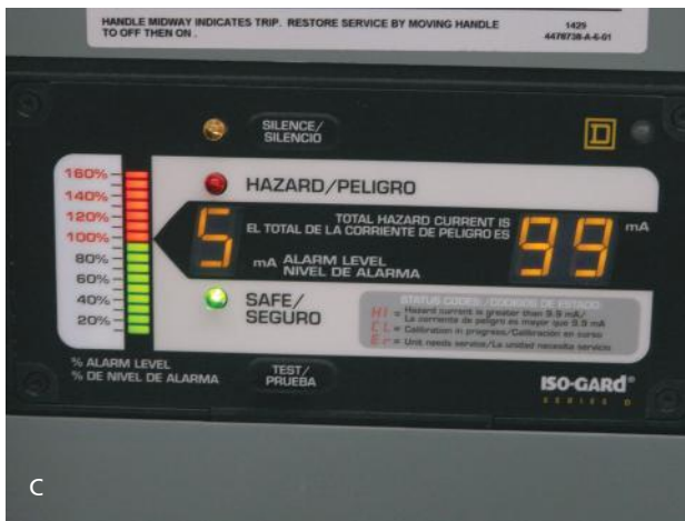
Şekil 5-26 LIM sayacı miliamper olarak kalibre edilir. Eğer güç sisteminin izolasyonu 2 mA üzerindeki bir akım geçebilecek şekilde düşürülürse, tehlike ışığı yanacak ve alarm sireni çalacaktır. Tehlike uyarı sistemi test düğmesine dikkat ediniz. A: Alarmı 2 mA'de çalıştıracak eski LIM. B: Alarmı 5 mA'de çalıştıracak daha yeni LIM. C: LIM alarmı çalışmış, kırmızı tehlike ışığı yanmış ve sağdaki Sayı 9.9 mA potansiyel akım gösteriyor.
