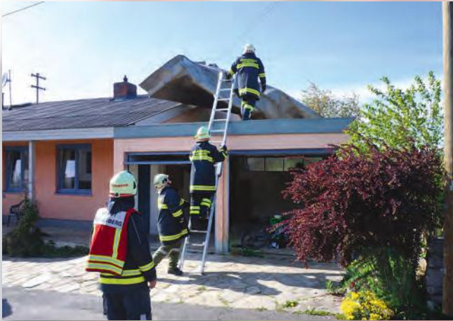
11.05.2016: Sturmschaden Manzenreith Einsatzleiter: OBI Haunschmied Gerhard
