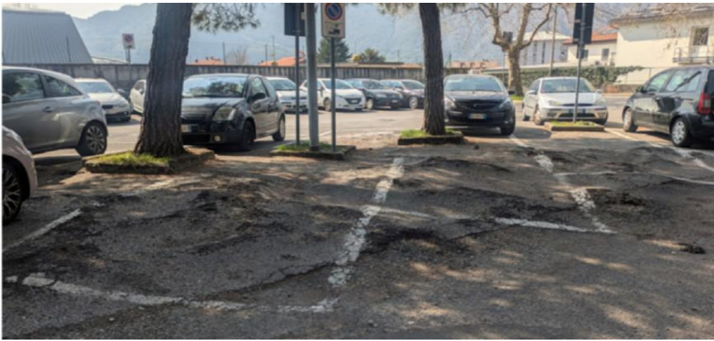
Il parcheggio del cimitero dissestato a causa delle radici dei pini marittimi che saranno tagliati
