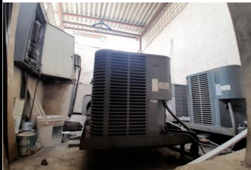
Vista Terraza Equipos Cubierta
