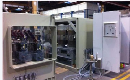
Armoire d'automatisme et contrôle — Moteur
