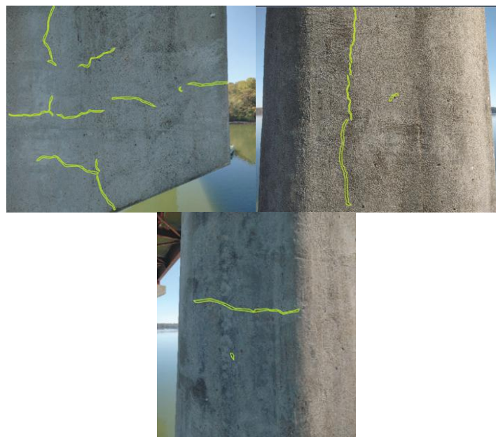
Fig. 3: Se captaron imágenes del pilar 5 mediante el UAS y posteriormente se emplearon para resaltar los defectos superficiales.
