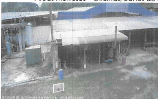
Área de generador eléctrico
