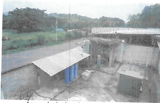
Area de tratamiento de agua
