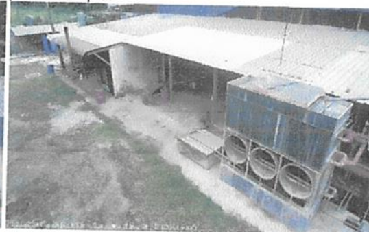
Vista del área de compresores
