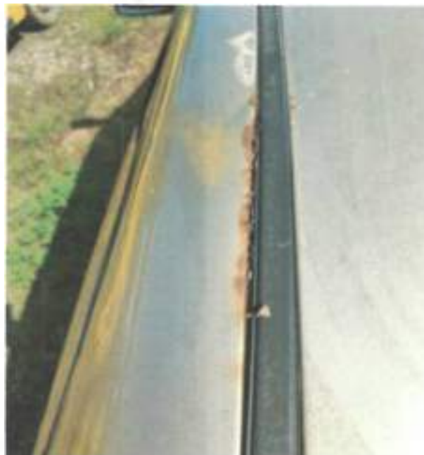
Fotografía 8, 9 y 10. Parte superior externa, lado izquierdo superior presenta corrosión y desprendimiento de pintura.
