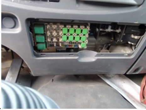
VISTA DE CAJA DE FISIBLES.
