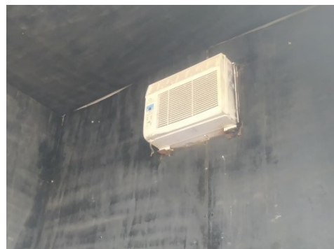
VISTA INTERIOR DE FURGÓN CORROIDO.
