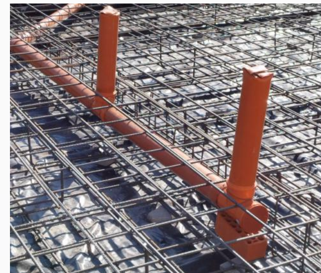
saneamiento en losa
