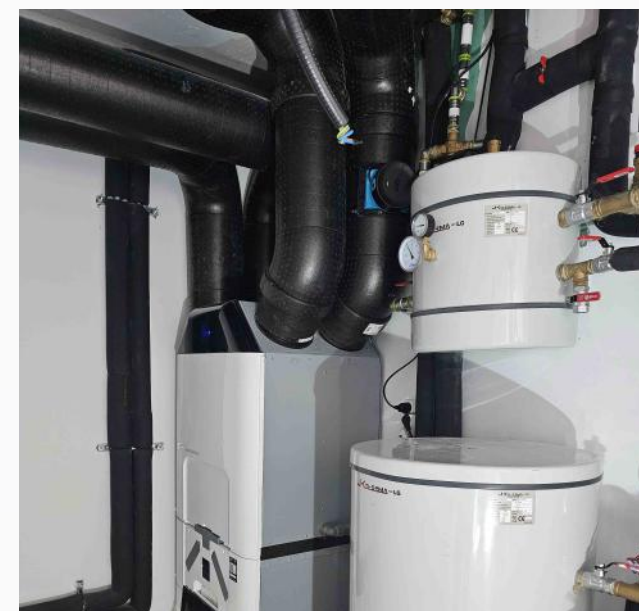
sala de máquinas YZ HUB
