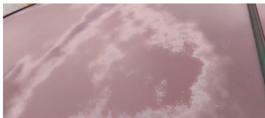
VISTA PINTURA EN MAL ESTADO
