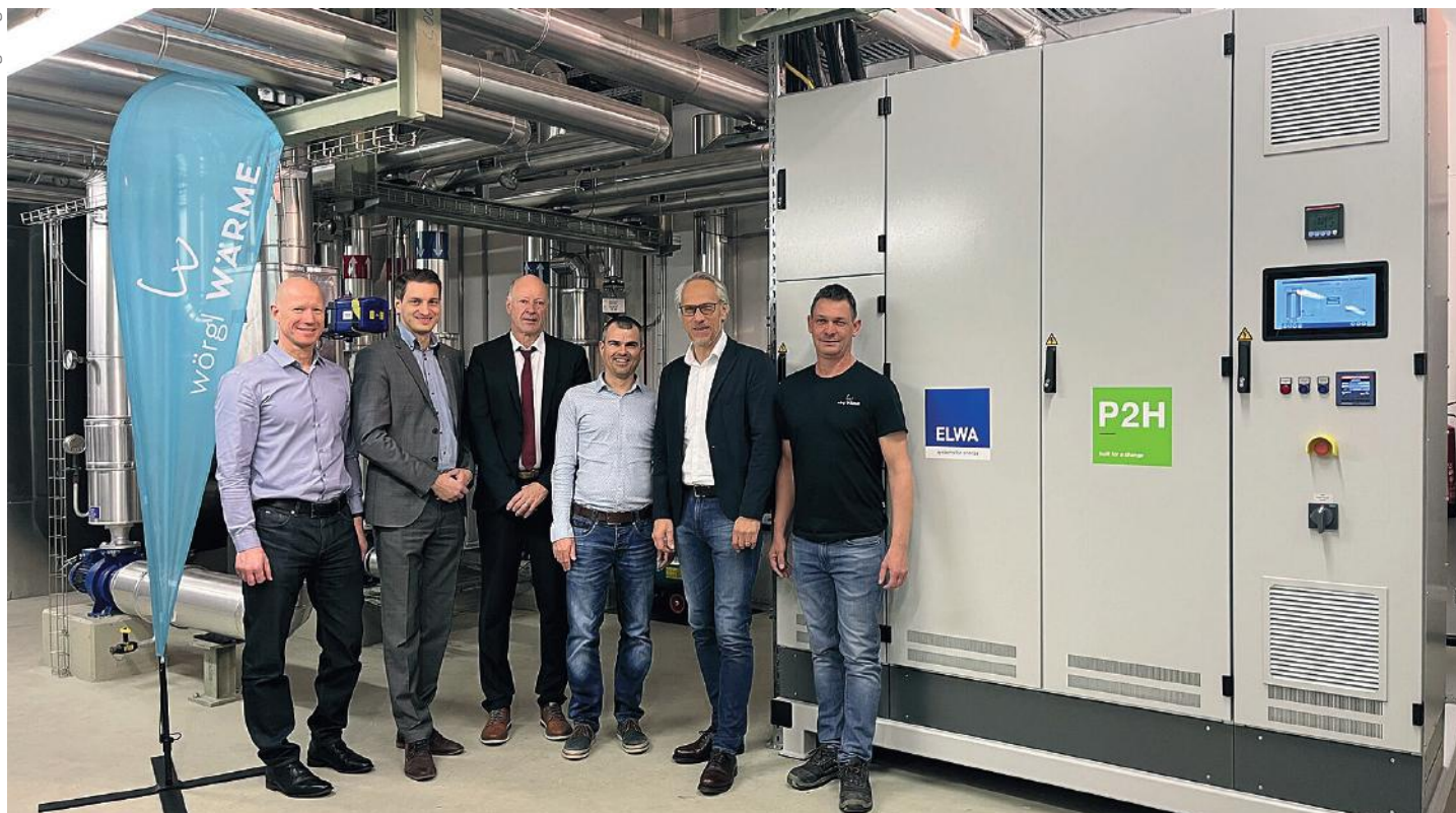
Vertreter der Projektpartner vor der 2025 in Betrieb genommenen Power-to-Heat-Anlage.
