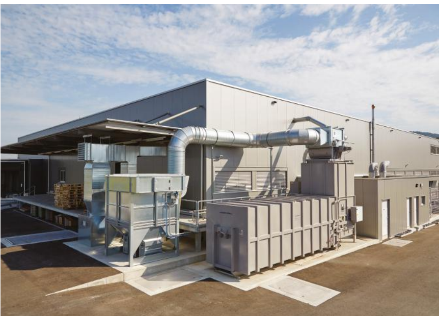
Absauganlage mit Filter und Vakuumventilator für selektiven Umluft- oder Frischluftbetrieb.
