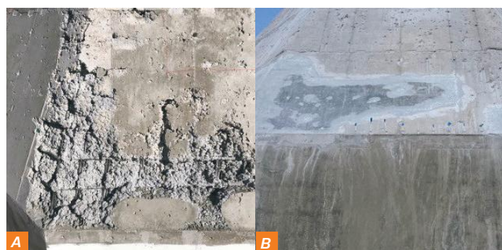
Fig. 1. Superficie encofrada que presenta concreto con oquedades (honeycomb) que necesita reparación: (a) antes de la reparación; y (b) después de la reparación (fotografía cortesía de Pivot Engineers, PLLC)
