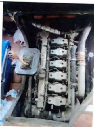
VISTA DEL MOTOR
