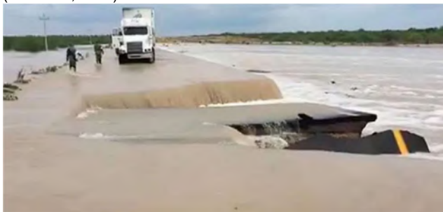
Figura 2. Camino inundado. La Gloria-Nuevo Laredo (milenio, 2017).
