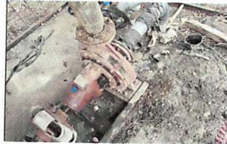
Motor en mal estado
