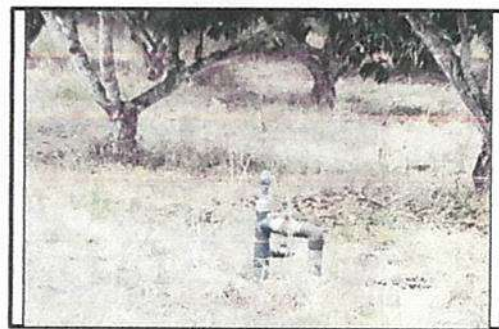
Modulo de riego
