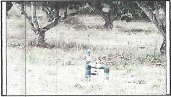
Modulo de riego
