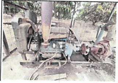
Motor en mal estado
