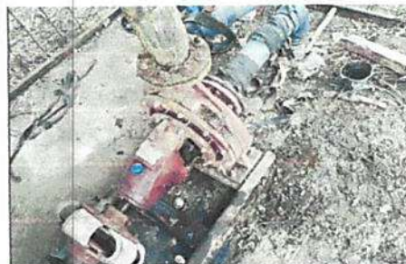
Motor en mal estado
