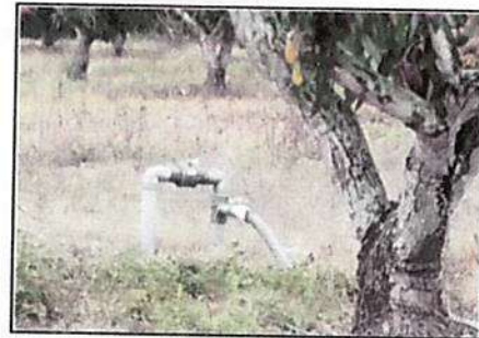
Modulo de riego
