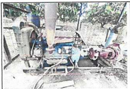
Motor en mal estado
