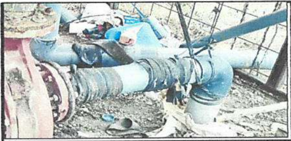
Pozo profundo de 80 m
