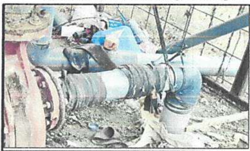
Pozo profundo de 80 m
