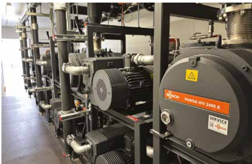
Zentrale Vakuumversorgung der Busch Group Schweiz für die Verpackungsanlagen bei Migros in Luzern.
