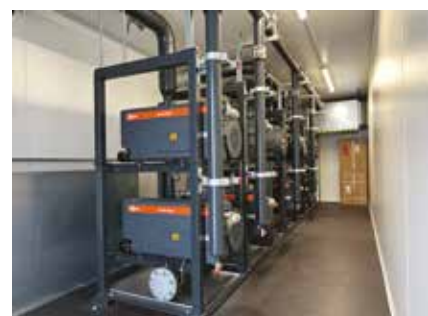
Im Container sind die Vakuumpumpen und Vakuum-Booster platzsparend und wartungsfreundlich angeordnet.
