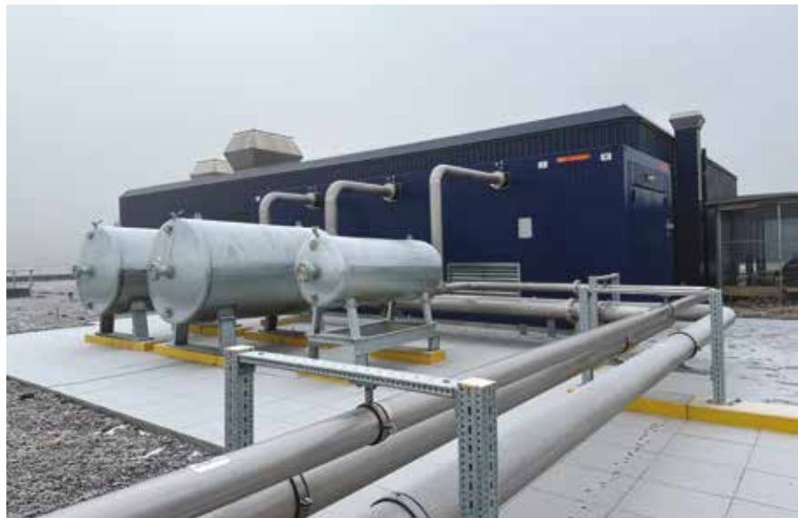
Die Vakuumzentrale wurde in einem Container außerhalb des Produktionsbereichs installiert.
