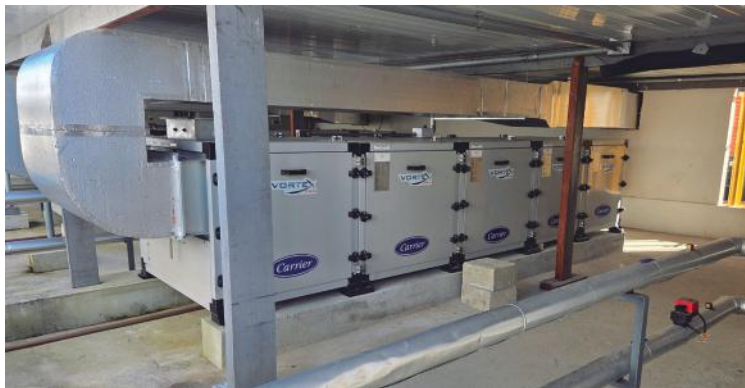
Casa de máquinas
