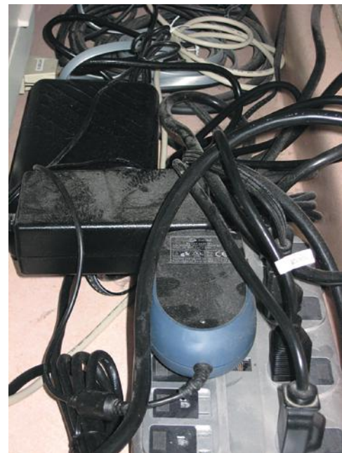
Şekil 15.7 Altı elektrik fişinin bağlı olduğu son derece güvensiz bir priz paneli.
