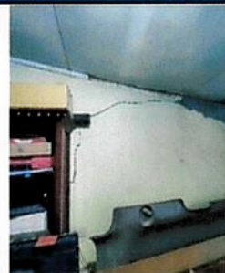
Edificación secundaria: Fallas estructurales
