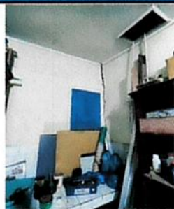
Edificación secundaria: Fallas estructurales
