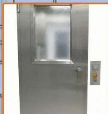
Sistemas de control de puertas esclusas
