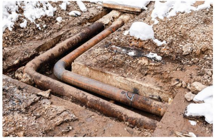
STEEL UNDERGROUND CONDUITS
