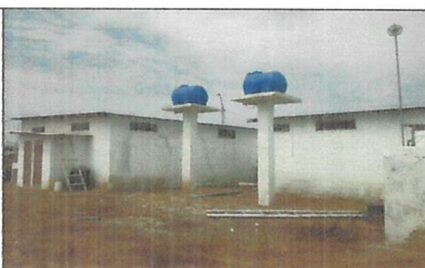
Foto #16: vista de tanques elevados
