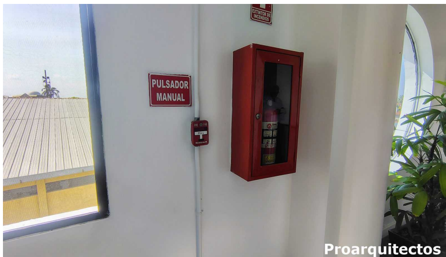
Detalle de armario contra incendios
