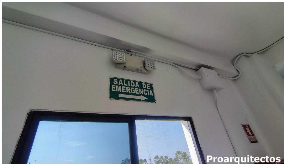
Detalle de iluminación de emergencia y señalética
