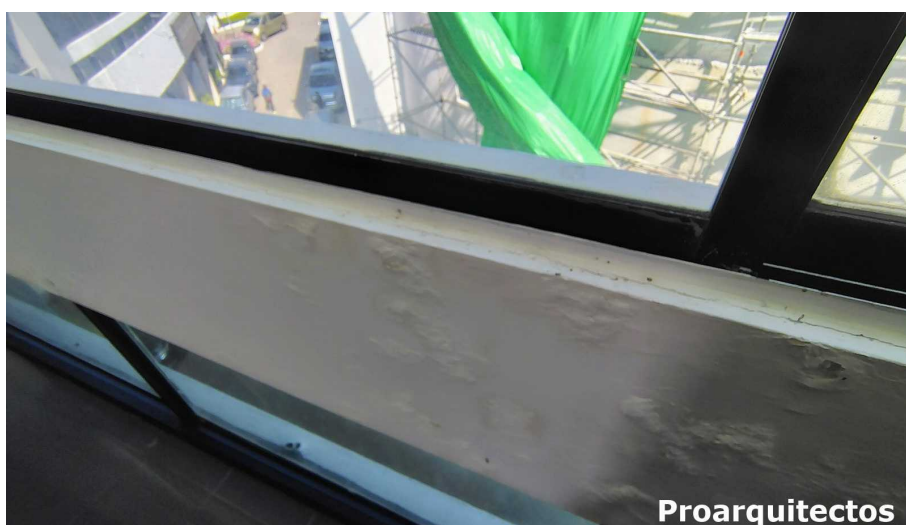
Detalle de filtraciones de humedad
