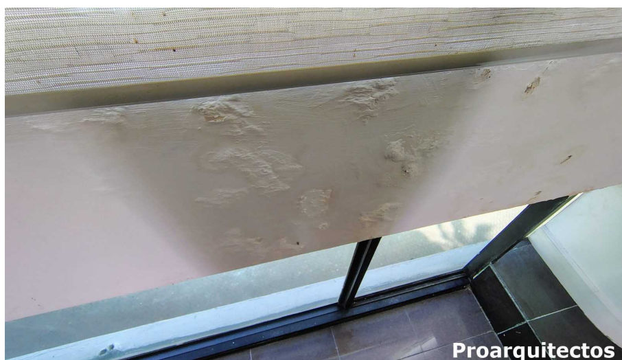
Detalle de filtraciones de humedad
