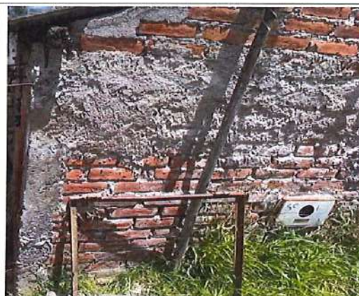
FOTOGRAFÍA N° 14 Medidor de Agua.
