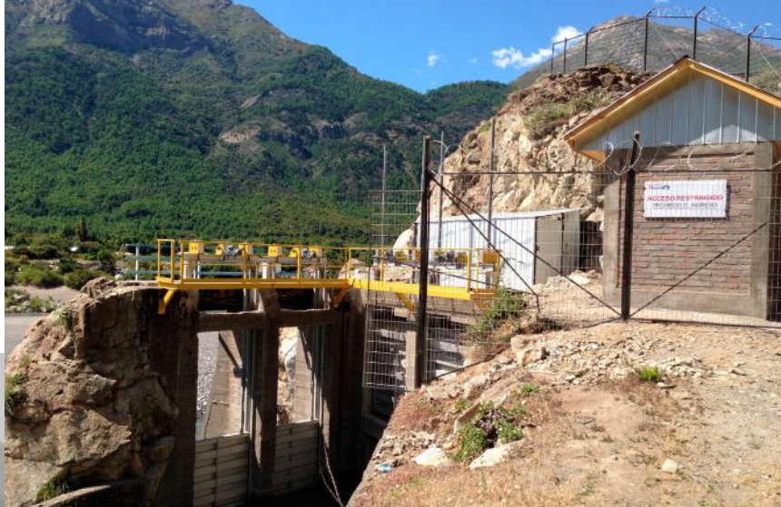
Apertura de compuertas de descarga con sistema de telemetría, Las Lajas, Armerillo (2026)
