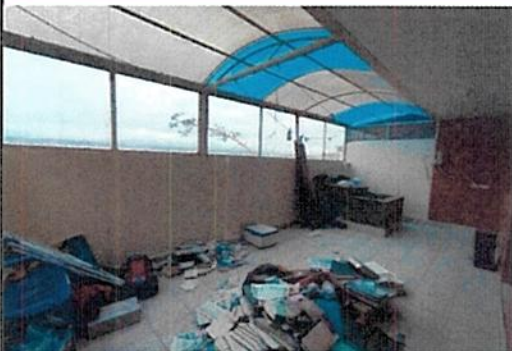
VISTA DE ÁREA DE SERVICIOS S1
