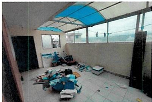
VISTA DE ÁREA DE SERVICIOS S1
