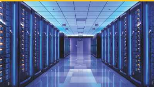
DATA CENTER / RECHENZENTREN
