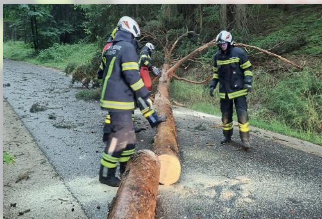
12.07.2023: Sturmschaden Güterweg Kellerbauer Einsatzleiter: Martin Waldmann Einsatzstärke: 16 Mann/Frau
