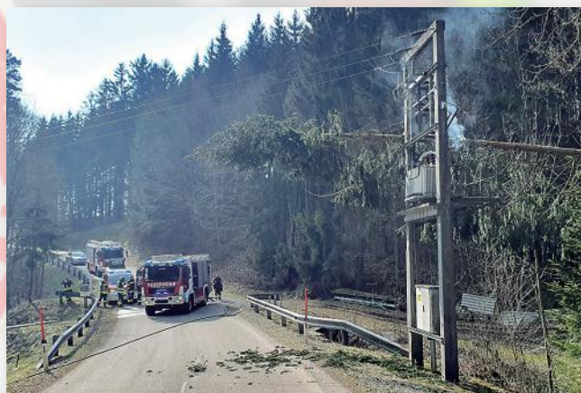
03.03.2023: Brand Trafostation Paben Einsatzleiter: Martin Waldmann Einsatzstärke: 20 Mann/Frau
