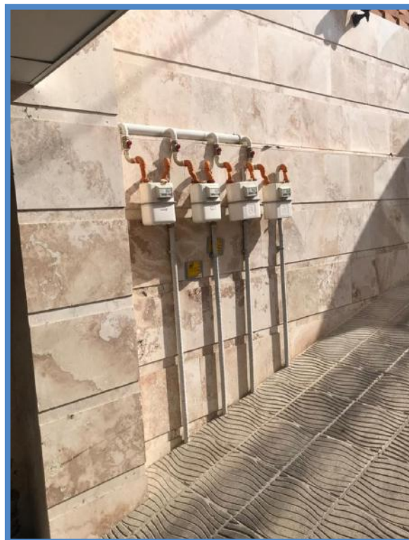
جانمایی نادرست کنتورهای گاز در رمپ
